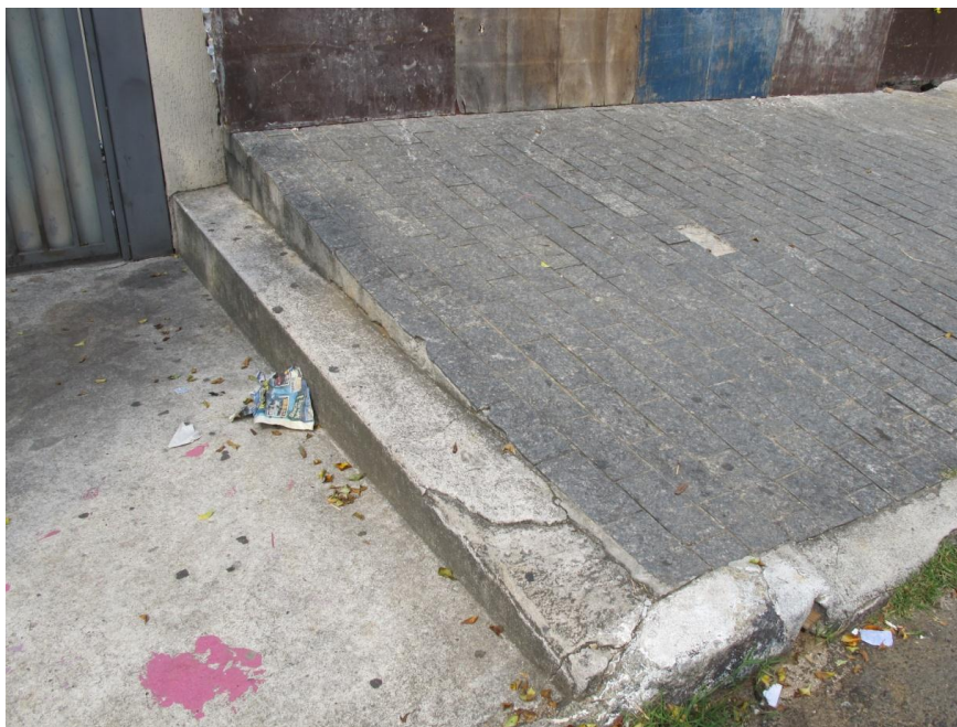
Figura - 59 Degraus e buracos dificultam acesso não somente de pedestres com mobilidade reduzida, mas de todos. Fonte: acervo da autora.
